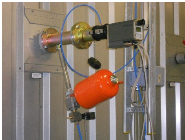
Abbildung 1: HEITRONICS-Lösungssystem eingebaut an einer Kesselwand in einer MVA
